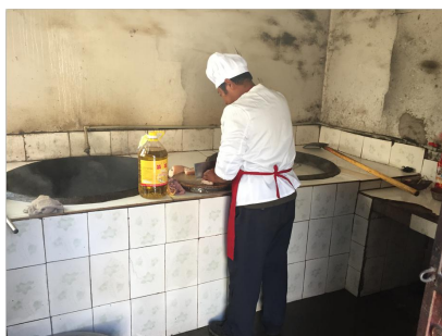
图 6 厨房墙面和地面情况图
