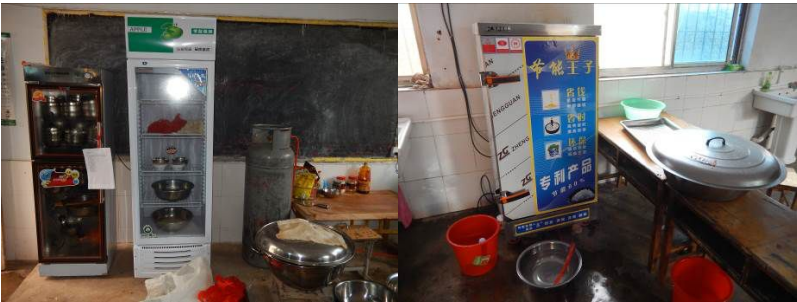
图 14 正常使用的厨房设备组图
