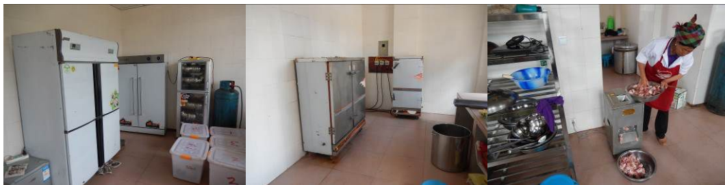
图 21 正常使用的厨房设备组图
