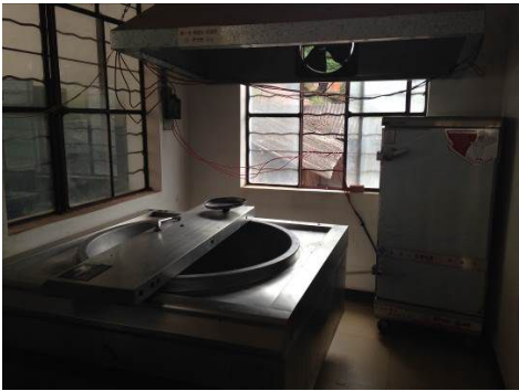
图 10 厨房故障设备
