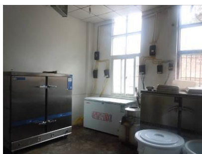
图6 厨房部分电器开关位置
